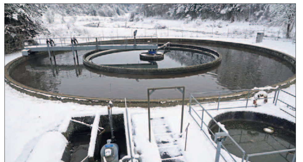
Die neue Belüftungstechnik für die Kläranlage in Wasserstetten wird im Januar eingebaut. Diese Arbeit übernehmen Taucher. FOTO: LENK
